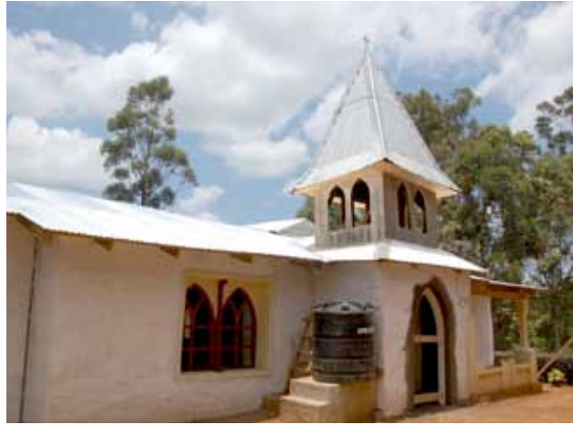
Die Restaurierungsarbeiten in Kidia gehen gut voran. Kürzlich wurden die neuen Türen und Fenster eingesetzt.
